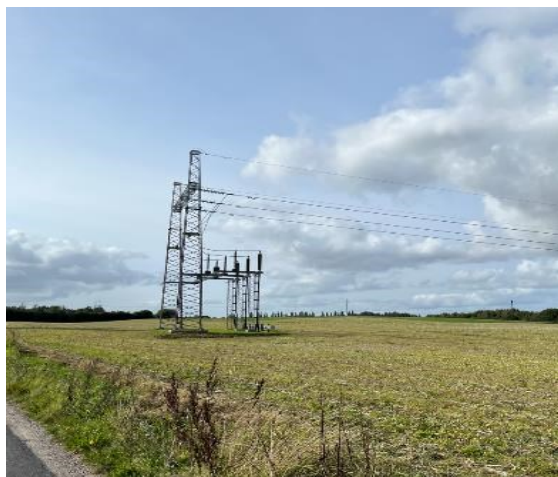
Figur 2 - Eksempel på en overgangsmast, hvor luftledninger og kabler kobles sammen.
